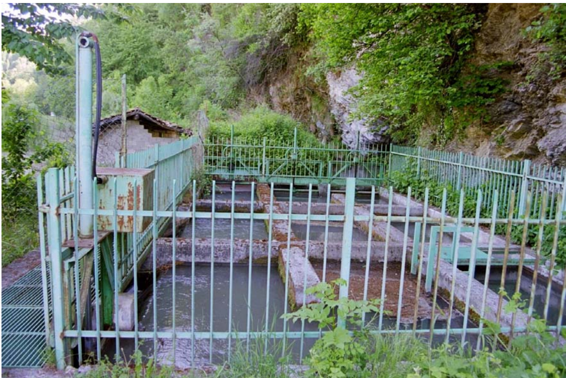
Photo 16: le dessableur du ru Baudin non loin d'Aoste
